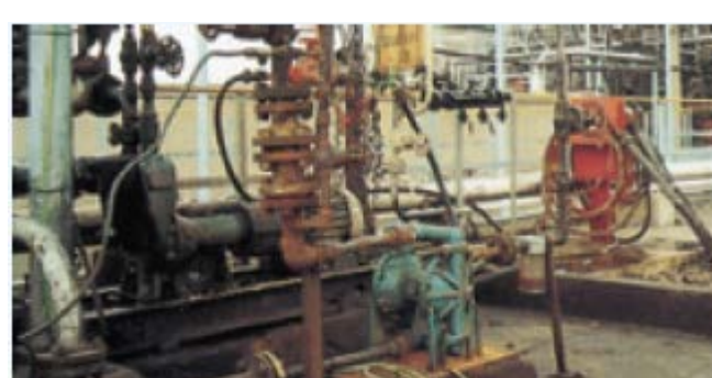
Металлические насосы Vlagdon 25 работают на крупном химическом предприятии в Северной Англии.
