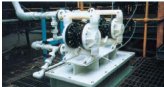
Литые насосы Vlagdon 25 из PVDF, перекачивают плавиковую кислоту.
