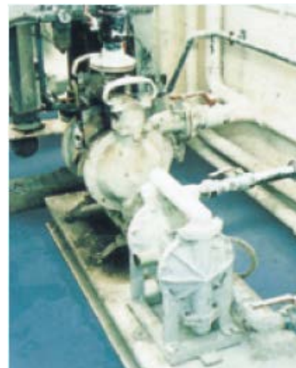
На рисунке показаны 2 насоса Vlagdon, установленные на керамическом заводе в Ройял Дултон (Royal Doulton). Агрегат на заднем плане перекачивал глиняный шликер в течение 8 лет без замены диафрагм, шаровых
