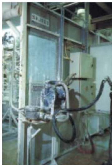
Металлический насос Vlagdon 25, установленный в Карадон Батрум (Caradon Bathroom), питает роботизированную установку по напылению глазури.
